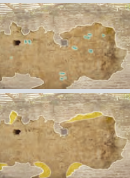
Documentación visual de un muro de Sirmium, Serbia. Arriba: localización de cavidades en azul; fondo: áreas con desprendimientos en amarillo.
