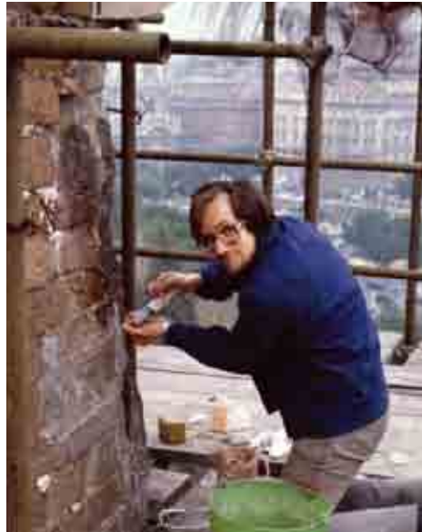
J. Malliet, 1985, inyectando mortero hidráulico en las Torres del Capitolio de Roma. Proyecto realizado por la Unidad de Formación a la Investigación.
