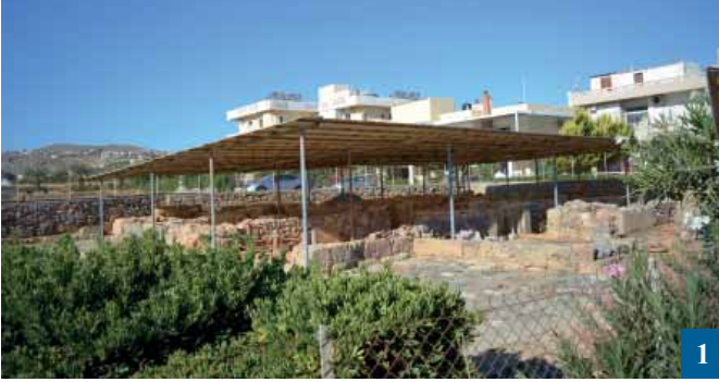
سقيفة مفتوحة الجوانب في موقع (نيرو خاني) Nirou Khani في جزيرة كريت اليونانية أدت إلى تلف الجدران تحتها بسبب عدم الصيانة. تصوير: ستيفانيا كلوفيراكي ©
