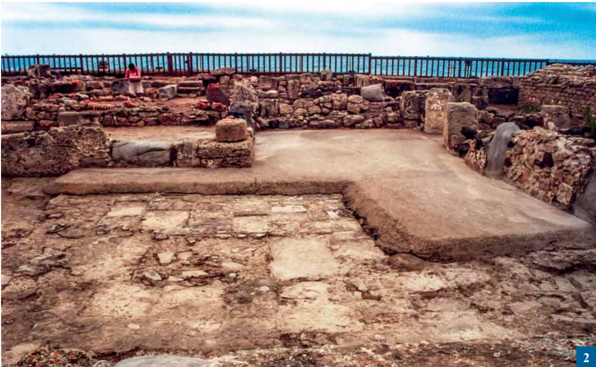
طبقة التغطية الواقية المصنوعة من خليط الإسمنت والجير تعزل السطوح تماماً عن الظروف البيئية المحيطة. الصورة مساهمة من مركز الحفاظ على الآثار، روما CCA.
