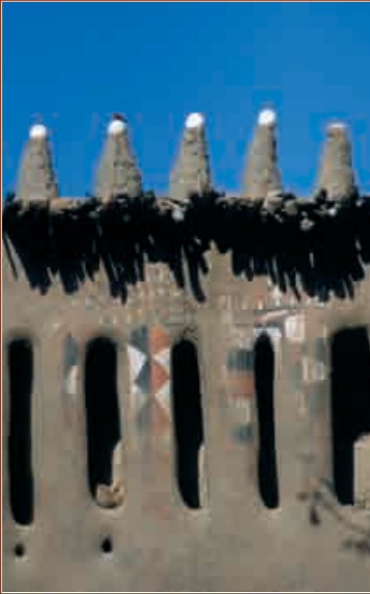
FIGURE 105 (en haut à gauche) Les peintures effacées par la pluie seront refaites.
