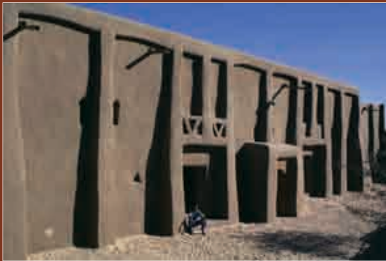
FIGURE 31 (en haut à gauche) Réfection de la façade Ouest de la mosquée de Djingarey Ber. Un travail important qui a assuré la bonne visibilité des travaux exceptionnels, principalement orientés sur un travail préventif, peu visible. Avant les travaux.
