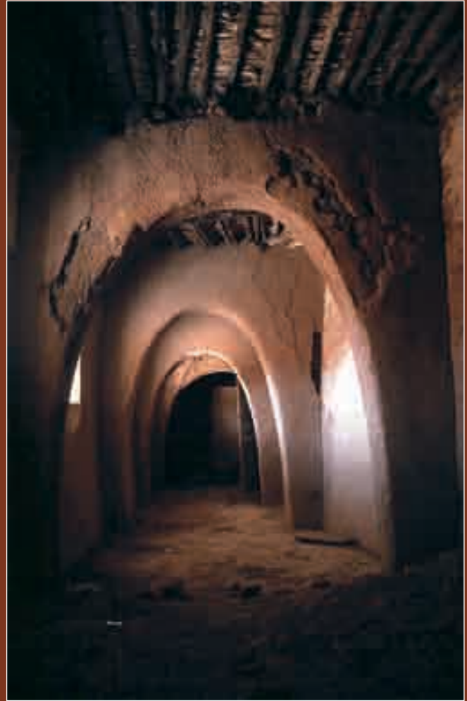
FIGURE 56 Le couloir Nord de l'étage, rythmé par des arcs tympans, espace ni utilisé et ni entretenu aujourd'hui.
