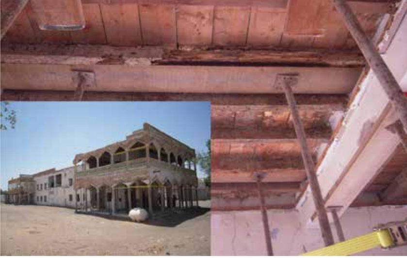
هيكل خشبي لأحد المباني عمل النمل الأبيض علي إضعافه ( نشرت الصورة بإذن من السيد خوسيه بيدرسولي جونيور).
