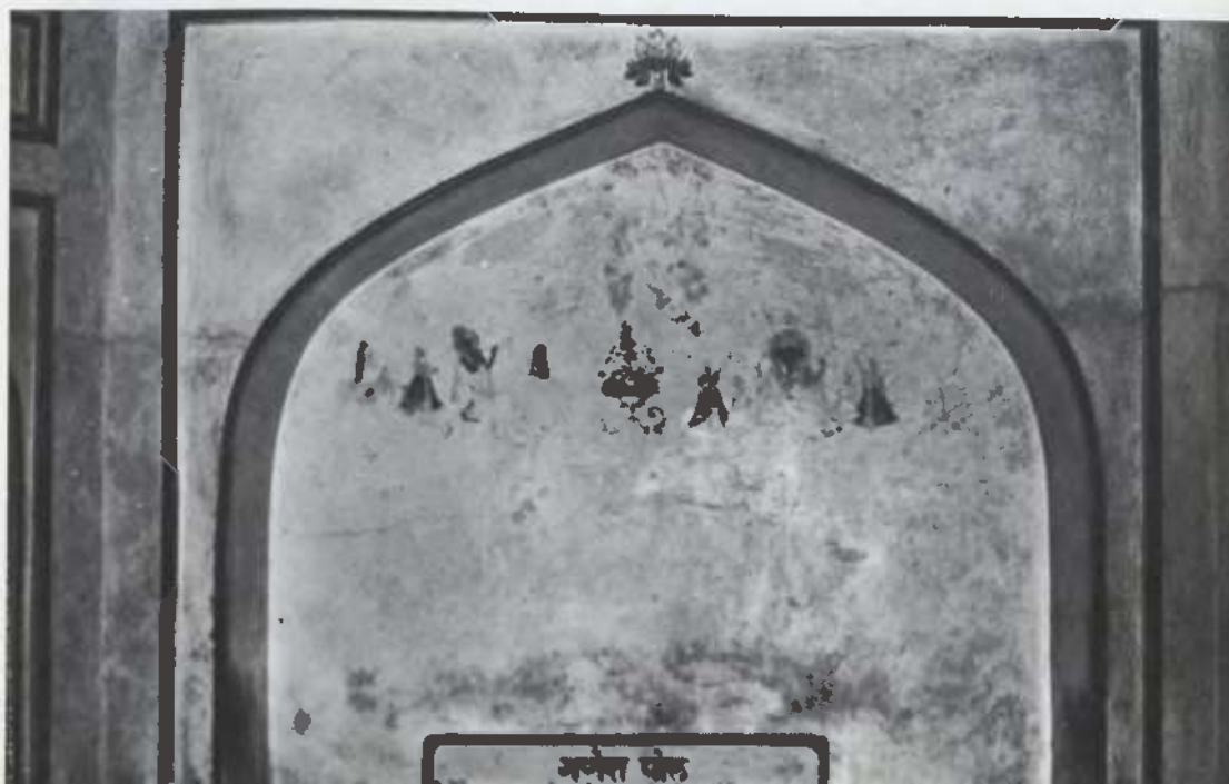
Pl. 41 - Amber Fort (Rajasthan). Décor peint d'une niche, montrant, vers la mi-hauteur, la trace horizontale du joint entre deux pontate .
