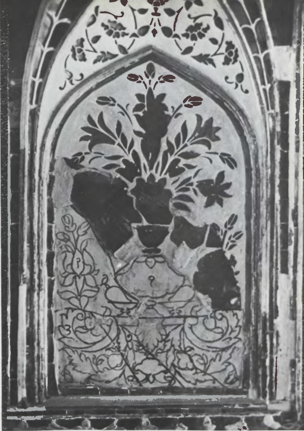
Pl. 44 - Amber Fort (Rajasthan). Décor combinant peinture et incrustation de pierres semi-précieuses. La chute de l'intonaco dans la partie inférieure d'une niche révèle la présence d'une sinopia (en noir) sur l' arriccio sous-jacent. La raison de cette phase préparatoire est certainement de préciser d'avance la localisation des divers matériaux à insérer dans la peinture. Telle doit être la signification des signes qui marquent certaines parties du dessin. (Détail de la Pl. 43).
