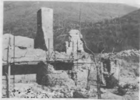
6. La consolidation du même secteur au moyen de techniques traditionnelles. (Photo février 1988).
