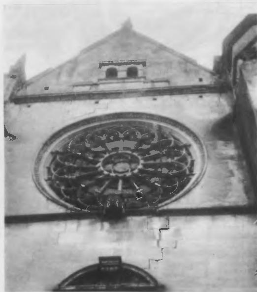
Détail des remplages (désordres)
