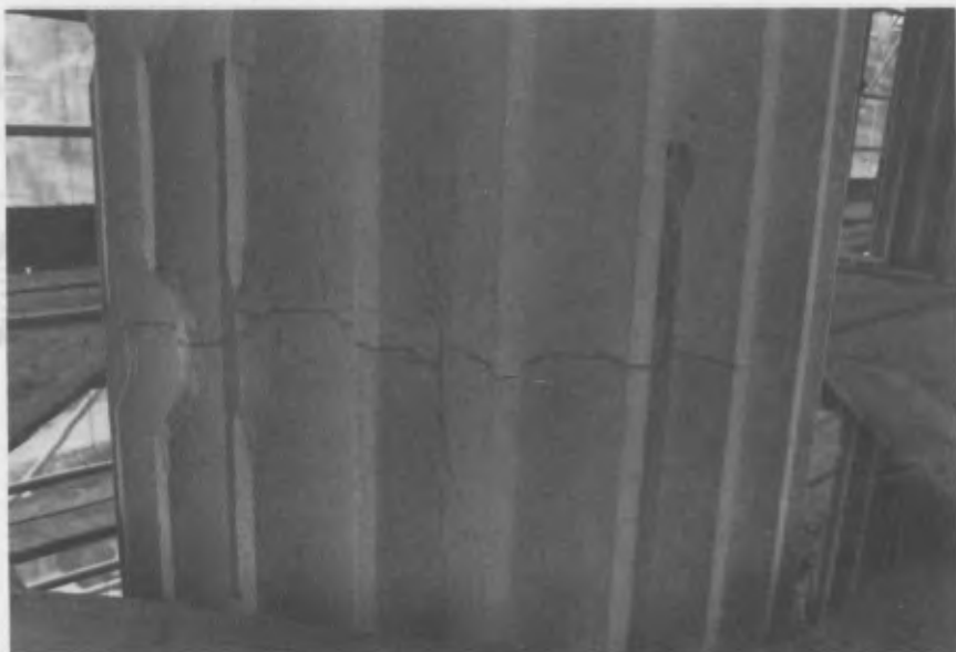
Fig.6 : Cracks in a drum of a column of the Tempio dei Castori
