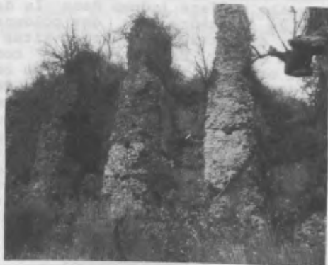
12. Etat de détérioration et amincissement de la section de base des éperons. (Photo mars 1987).
