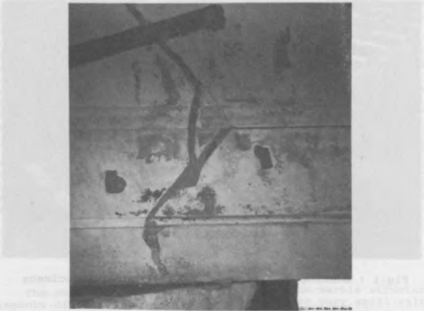
Fig.3 : Cracks in the architraves of the Tempio dei Castori
