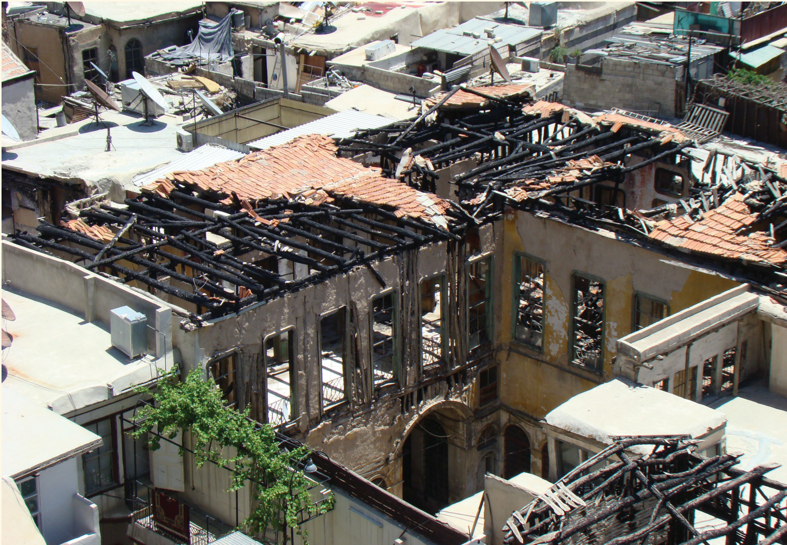
منزل تراثي تضرر بفعل الحريق والدوران. (الصورة: فراس عثمان)
